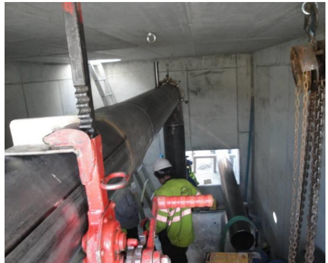
Schachtbauwerk für Sektionierung der Fernwärmeleitung
