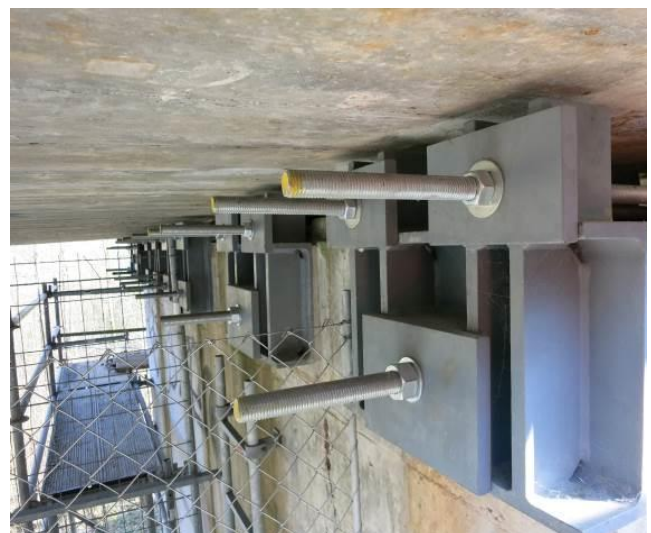
Sofortmassnahmen zur Sicherung der Lagerbank
